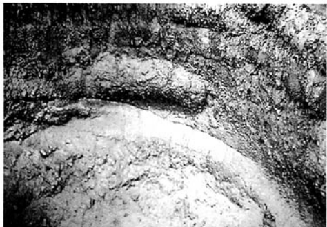
图 4 使用 311 炉次后炉底耐火材料情况
